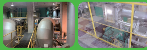
排ガス処理設備
