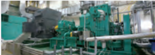
▲蒸気タービンと発電機
