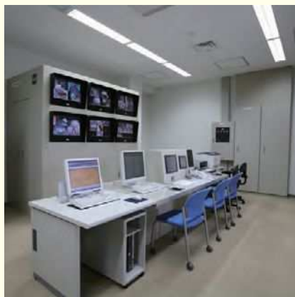
中央制御室(リサイクルプラザ) Central control room (Recycle plaza)
